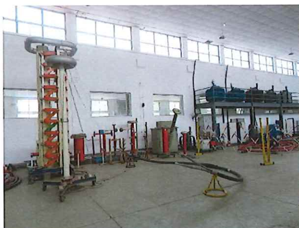
C3: 冲击电压试验 Impulse voltage test
